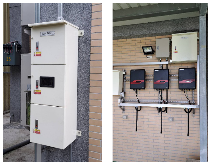
太陽能板設施
